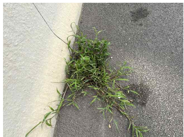
배수시설 S2 배수구 토사퇴적
