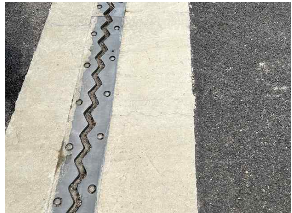
신축이음 A2 후타재 균열(Cw=0.3mm미만)
