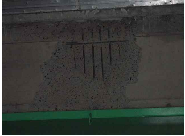
바닥판 하면 S2 파손 및 철근노출(0.5×0.5)
