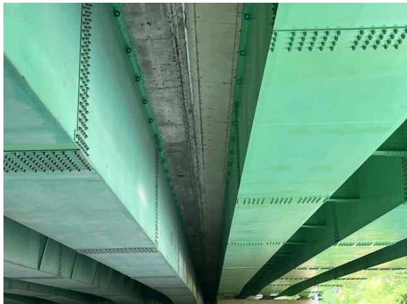
바닥판 하면 S1 상태양호
