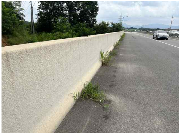
배수시설 S1 배수구 토사퇴적
