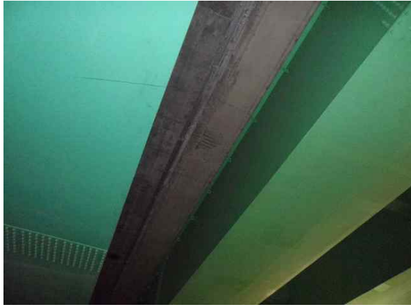
바닥판 하면 S2 파손 및 철근노출(0.5×0.5)
